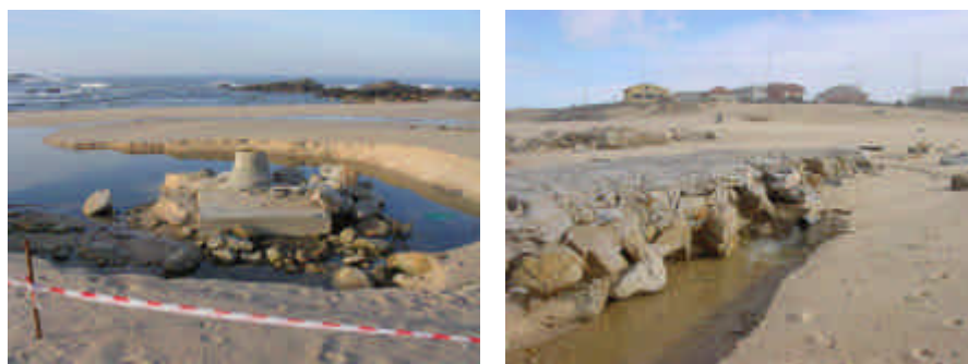
Figura 4.82 – Esgoto na praia.
